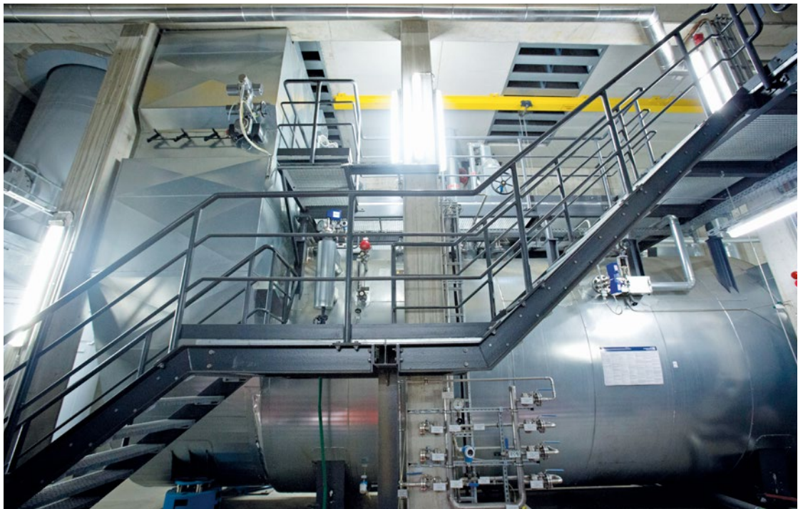
In der Energiezentrale wird auch die Energie genutzt, die sonst aus dem Schornstein entweicht. Diese Anlage erzeugt aus dem Abgas der Gasturbine Dampf und heißes Wasser. Daraus wiederum kann Kälte entstehen.
