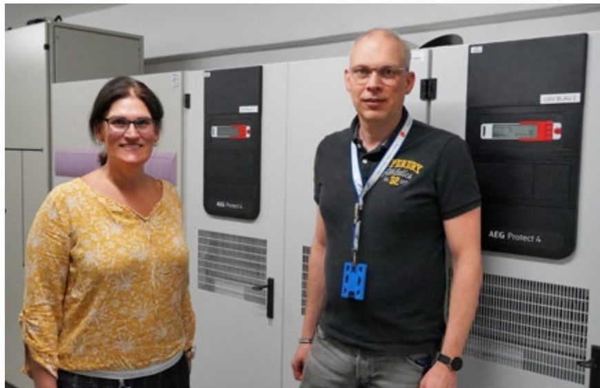
Eva-Christina Przybylski und Heiko Stenzel vom Technischen Gebäudemanagement (TGM) vor den neuen USV-Blöcken. Foto: Anja Naumann
