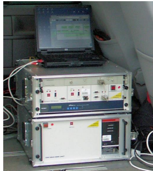
Abb. 8: UGM im mobilen Einsatz mit zertifiziertem GBAS Multi Mode Receiver (MMR)
